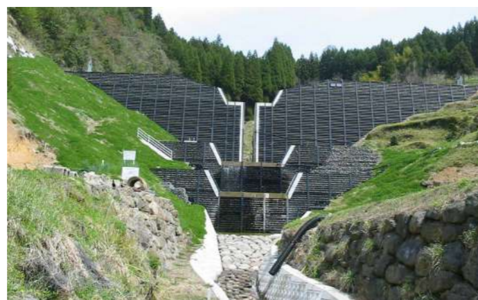
落水砂防ダム（軟弱地盤につき軽量鋼製フレーム材で施工）
